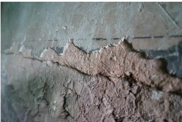
图 2-51 壁画底部脱落部位
