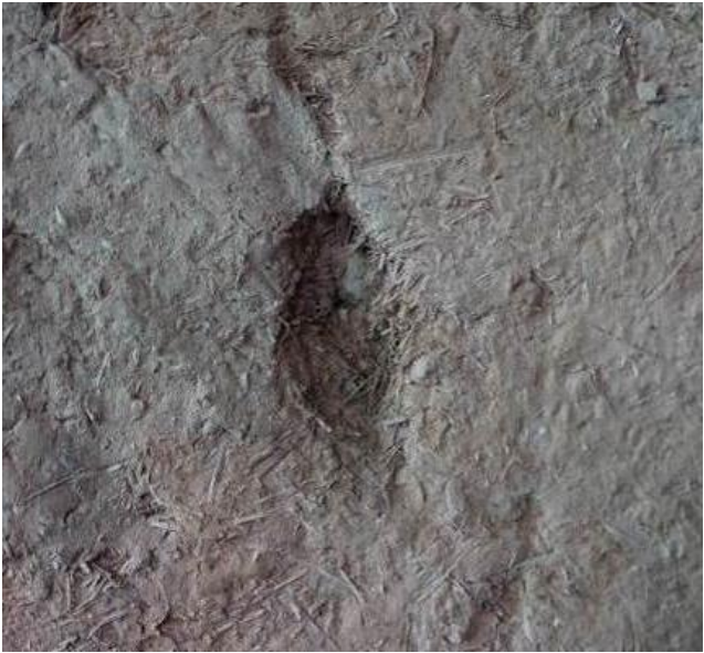
图 5-37 修复前 泥质地仗层脱落修补试验区 2:
