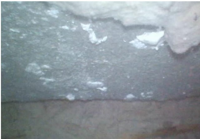
图 2-21 内窥镜下探明左侧裂隙已贯穿墙体
