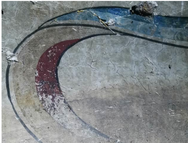
图 2-53 壁画颜料层局部片状脱落
