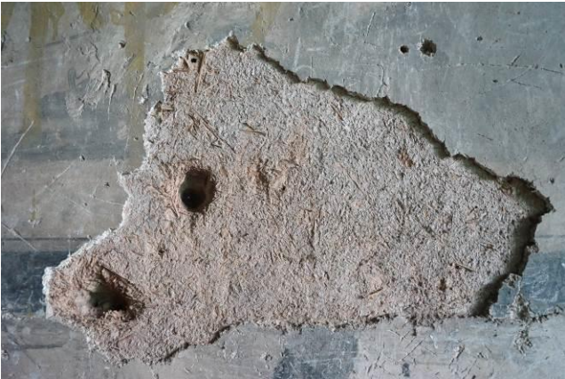
图 2-49 壁画局部脱落部位
