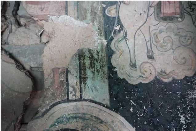
图 2-48 壁画中心脱落部位
