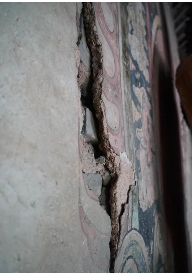
图 2-57 主尊左侧局部裂隙
