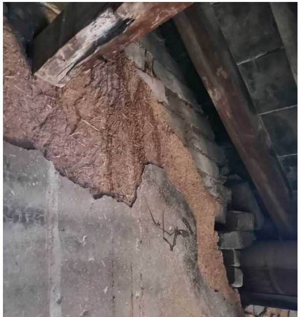
图 2-30 东壁顶部渗水处
