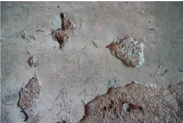
图 2-50 壁画底部脱落部位
