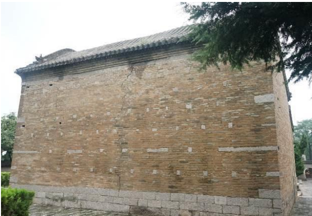
图 2-22 大雄宝殿北壁外侧裂隙
